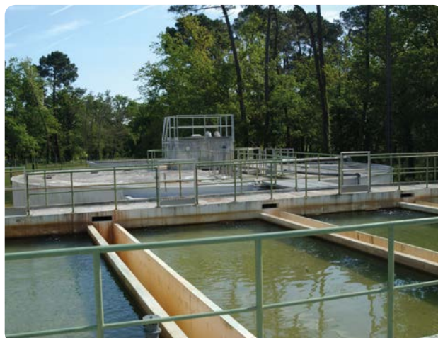
BASSIN DE FILTRATION DES SOURCES DE GAMARDE Photo : Bordeaux Métropole
