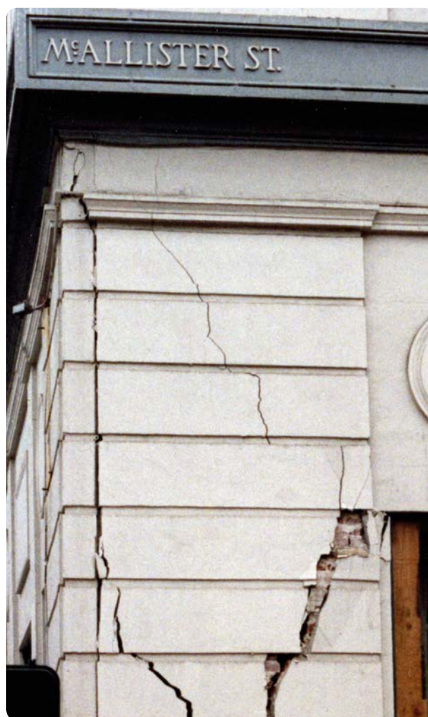
FISSURES DANS UN BÂTIMENT LORS DU SÉISME QUI A FRAPPÉ SAN FRANCISCO LE 17 OCTOBRE 1906
