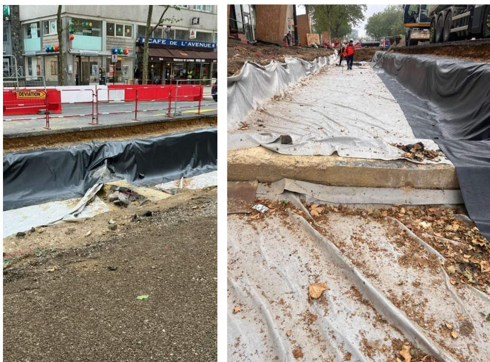
Figure 3 : Canalisation abandonnée Enedis (HTA) en travers de la tranchée drainante
