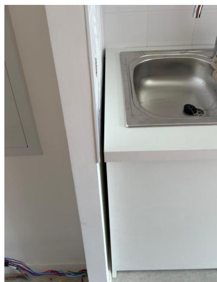
Figure 31 : Non-alignement de la cloison avec le meuble (Source : production personnelle)
