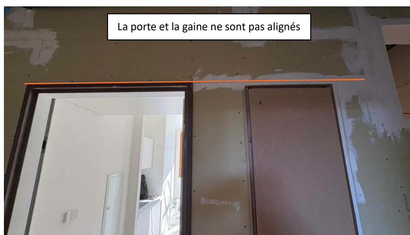
Figure 29 : Non alignement de la porte palière et de la porte de gaine (Source : production personnelle)
