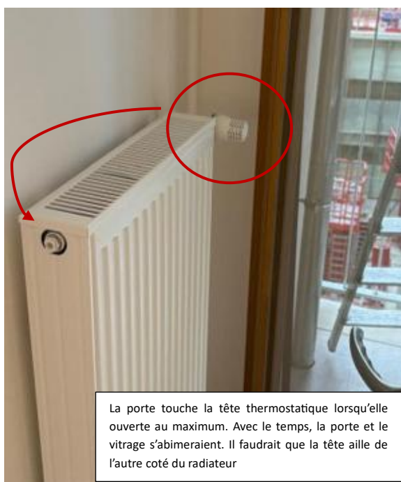
Figure 34 : Conflit entre la tête thermostatique et la baie de la menuiserie (Source : production personnelle)
