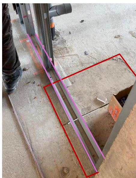
Figure 27 : Rails des SAD traversant la réservation censée accueillir la gaine STAFF
