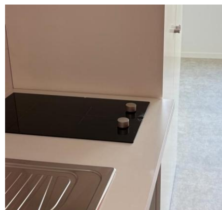
Figure 37 : Non-alignement de l'armoire avec le meuble bas de la kitchenette (Source : production personnelle)
