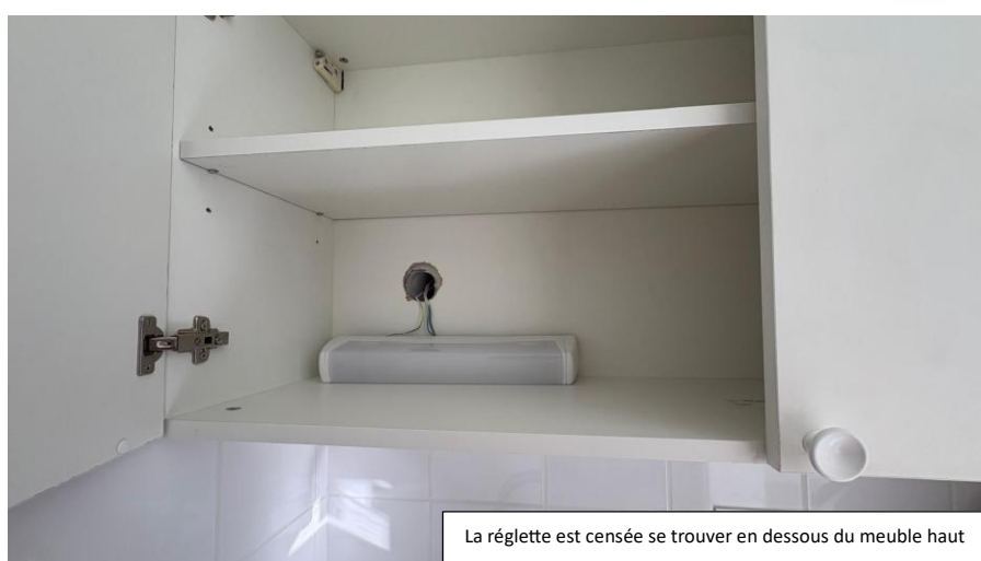
Figure 33 : Mauvaise implantation de la réglette de kitchenette (Source : production personnelle)
