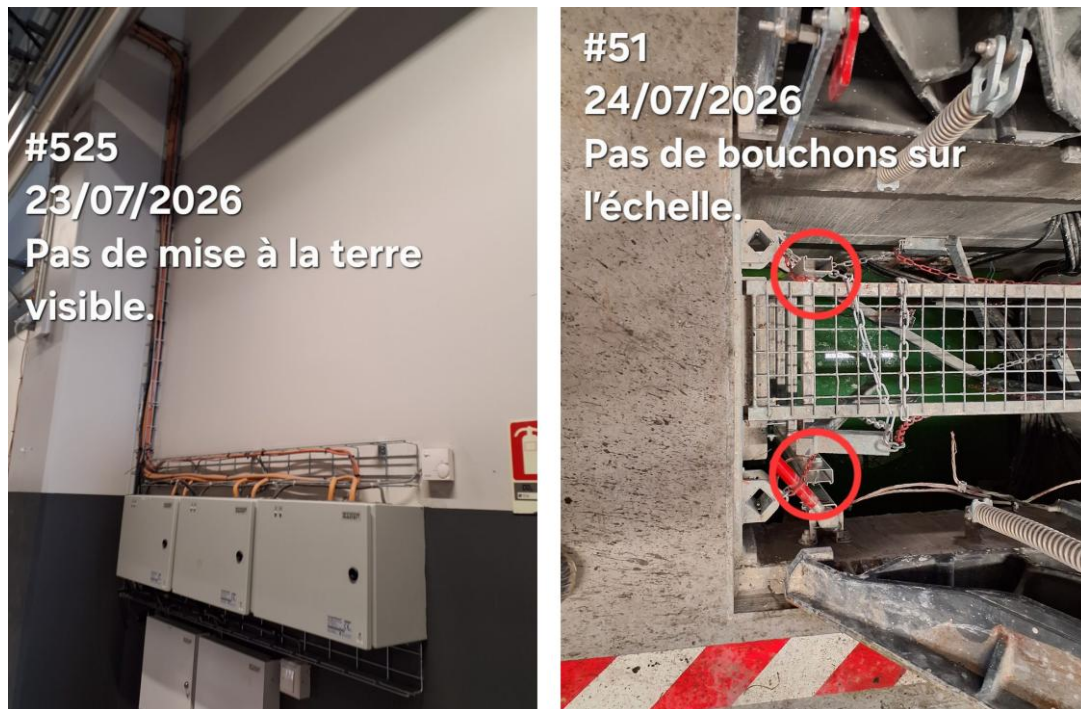
Figure 11 : Réserves maintenues après vérification contradictoire sur site : à gauche, absence de mise à la terre visible des coffrets de désenfumage (réserve n°525, 23/07/2026) ; à droite, absence de bouchons de protection en extrémité d'échelle à câbles (réserve n°51, 24/07/2026). Source : photos personnelles annotées, A. Bouselma, AMT Massy-Palaiseau, 2026.
