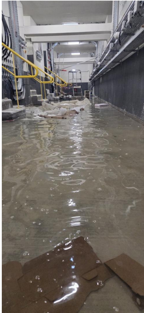
Figure 20 : Inondation d'une galerie technique par remontées d'eau, consécutive à un défaut d'étanchéité du cuvelage (source : photo personnelle, A. Bouselma, AMT Massy-Palaiseau, 2026).
