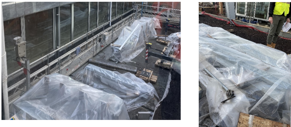
Figure 15 : Première méthode de stockage des tôles, (source : production personnelle)
