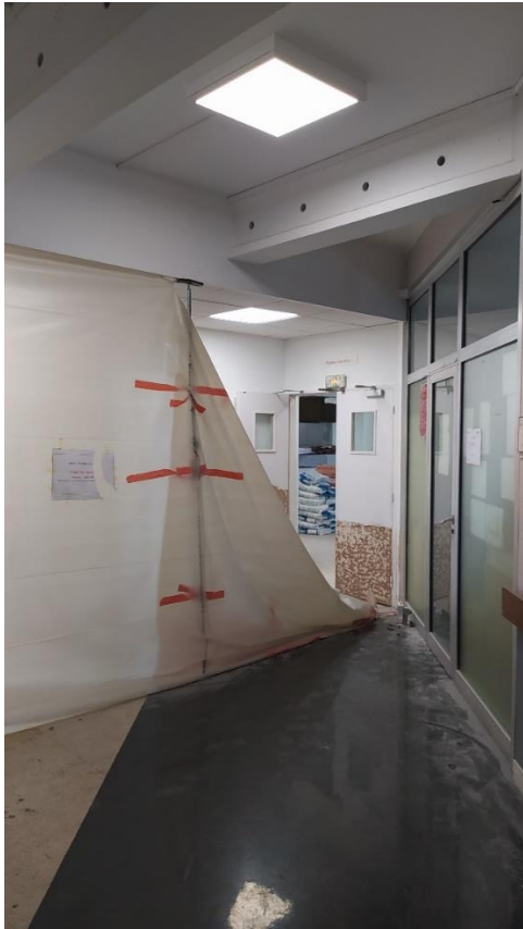
Figure 23. Photo du polyane dans un état dégradé lors du chantier. On constate qu'il y a de la circulation à travers ce polyane. Dans cette situation l'étanchéité du chantier est compromise et un rappel important a été fait à toutes les entreprises du chantier (@ Léo Serra).
