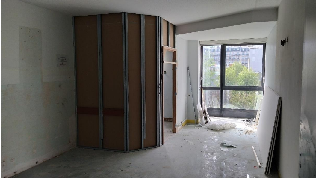
Figure 19. Photo d'une chambre double lors des travaux. Les cloisons délimitant la nouvelle salle de bain sont en train d'être posées. On peut observer le renfort installé pour permettre de supporter le nouveau lavabo. Ces renforts sont composés de morceaux des anciennes main courantes du service (© Léo Serra).
