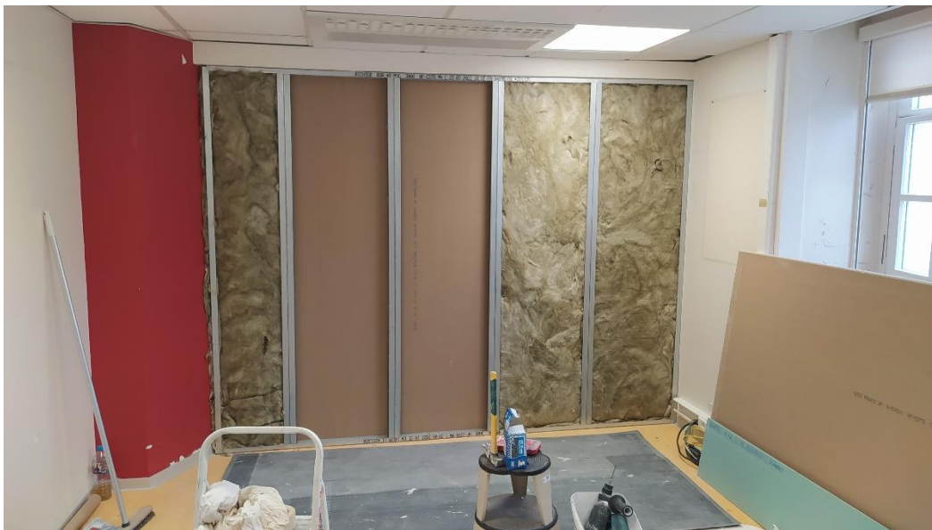
Figure 34. Photo du cloisonnement d'une ancienne salle d'effort en un poste de soins et une salle d'HDJ 12 (©Léo SERRA)
