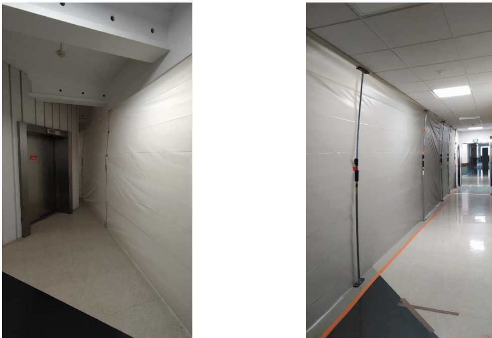
Figure 22. Photos du rideau de polyane, soutenu par des perches, établi avant le début des travaux pour isoler la zone chantier (à droite) du reste du service et notamment du hall où l'on trouve les ascenseurs (à gauche) (© Léo Serra).
