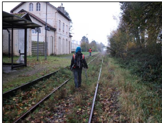
Figure 10. Croissance de végétations au niveau d'un quai dû à la non-évacuation des eaux – Source interne
