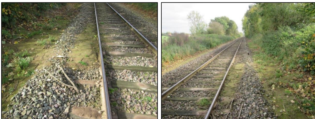
Figure 7. Photographies de coulées de boues sur une voie - Source interne
