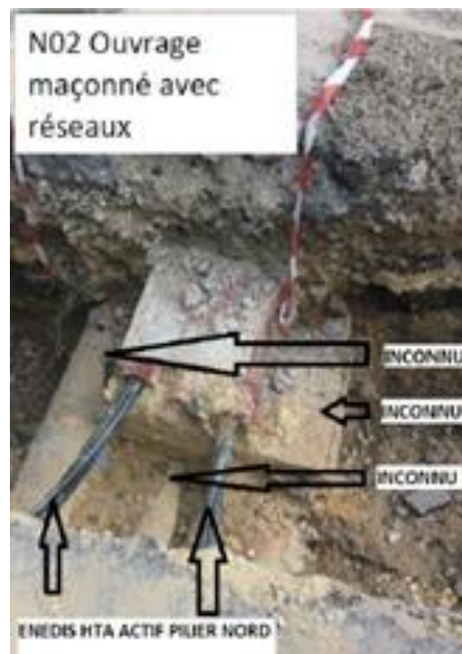
Figure 15 : Découverte de réseaux inconnus sur le chantier de la Tour Eiffel (source : OGI)
