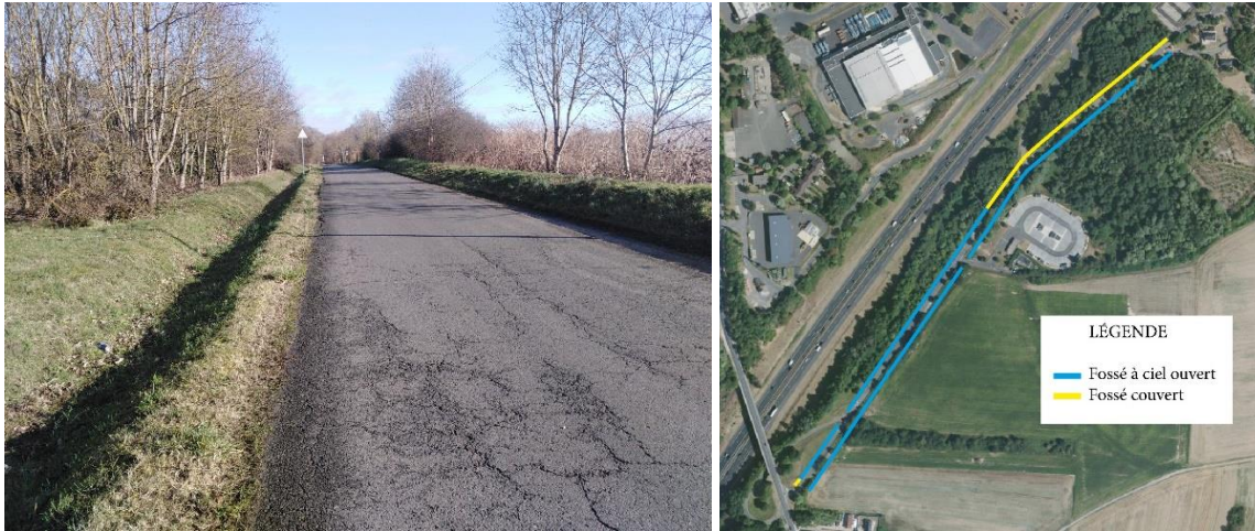
Illustration 31 : vue sur le fossé, du côté nord de la chaussée (© IRIS Conseil) Illustration 32 : plan de réseau d'assainissement EP (© Géoportail, © IRIS Conseil)
