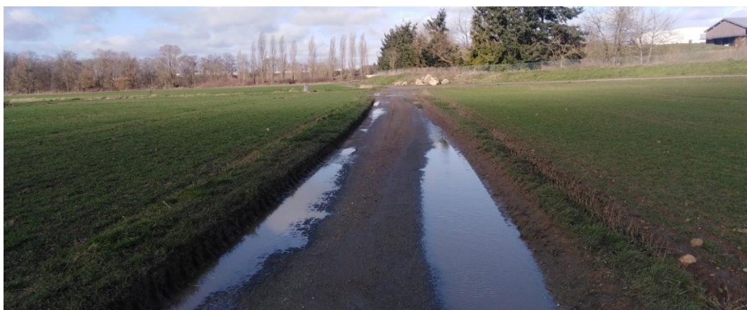
Illustration 35 : chaussée en terre en partie inondée (© IRIS Conseil)
