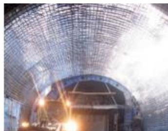
Figure 10: Exemple de montage d'arc en acier (gauche) et de maille en acier (droite) renforçant la structure primaire
