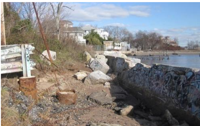
Figure 13 : Restes du mur en béton effondré
