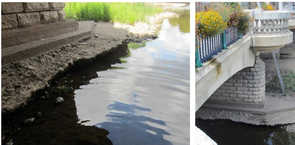
Figure 15 : Etat des piles du pont Denfert-Rochereau (photos : Egis)
